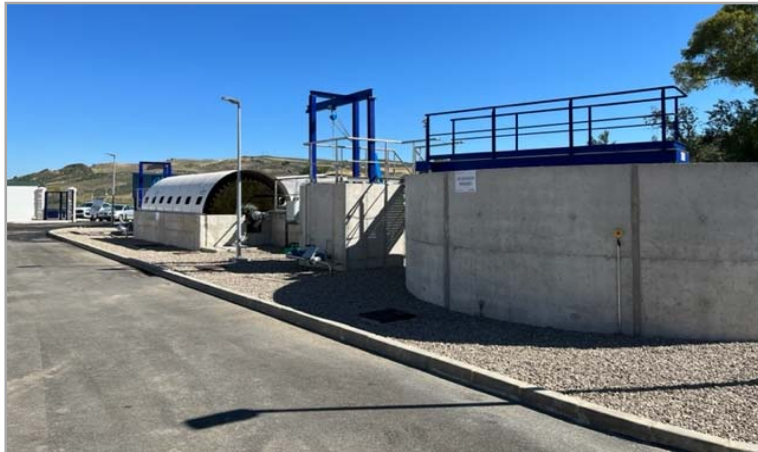
Detalle de la EDAR de Algámitas.
